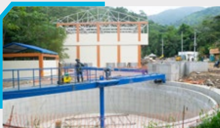
Planta de Tratamiento de Lodos para la Planta de Tratamiento de Agua potable (PTAP) Rafael Ardila Duarte y la PTAP Bosconia. Capacidad de 150 m 3 /día de caudal filtrado y 10,3 ton/día de lodos. Bucaramanga, Colombia.
